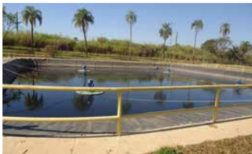
Estação de Tratamento de Esgoto Camanducaia (Jaguaruiuna)
