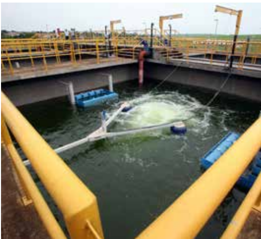
Estação de Tratamento de Esgoto de San Martin (Campinas)
